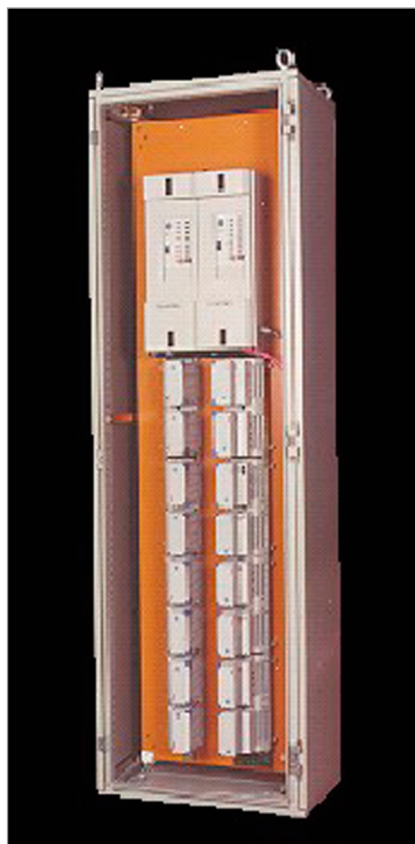
Figura 1. Ejemplo de Controladores y Módulos de Entradas/Salidas de Ovation®
