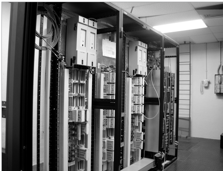
Figura 6. Instalación del Control de Turbina.
