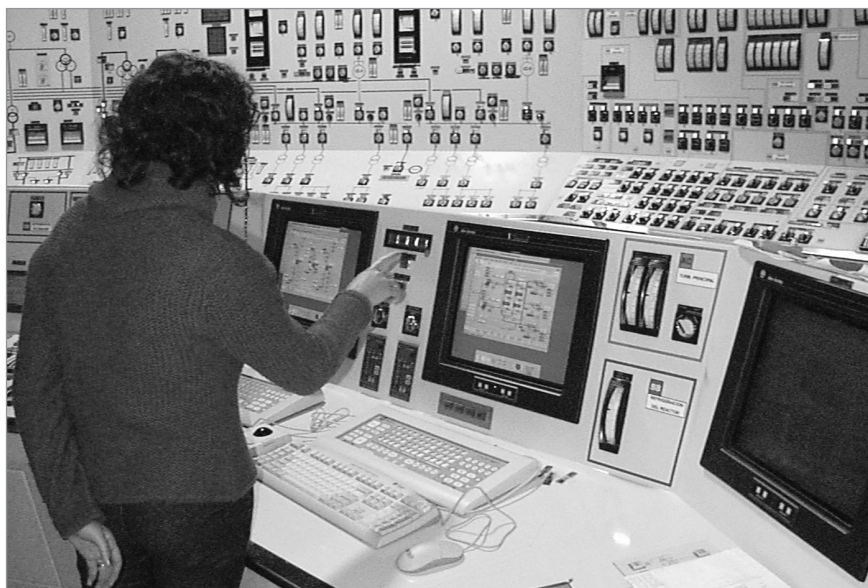
Figura 13. Entorno de supervisión y control OVATION. Simulador de CN Vandellós II.
