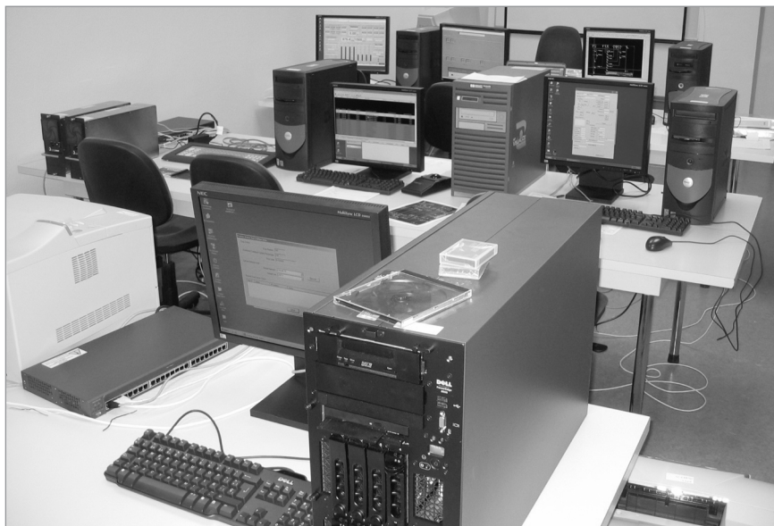
Figura 15. Sistema de control DEH de turbina Banco de pruebas simulador de CN Almaraz.
