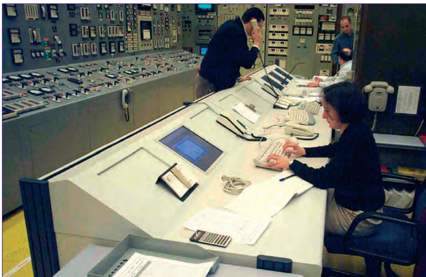
Sala de control de C.N. José Cabrera.
