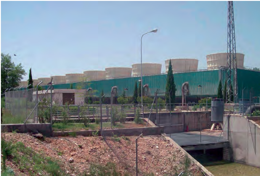
Torres de refrigeración.
