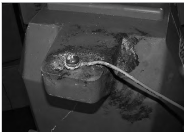
Figura 4: Transformador de tensión con "tracking" en la superficie debido a descargas parciales.
