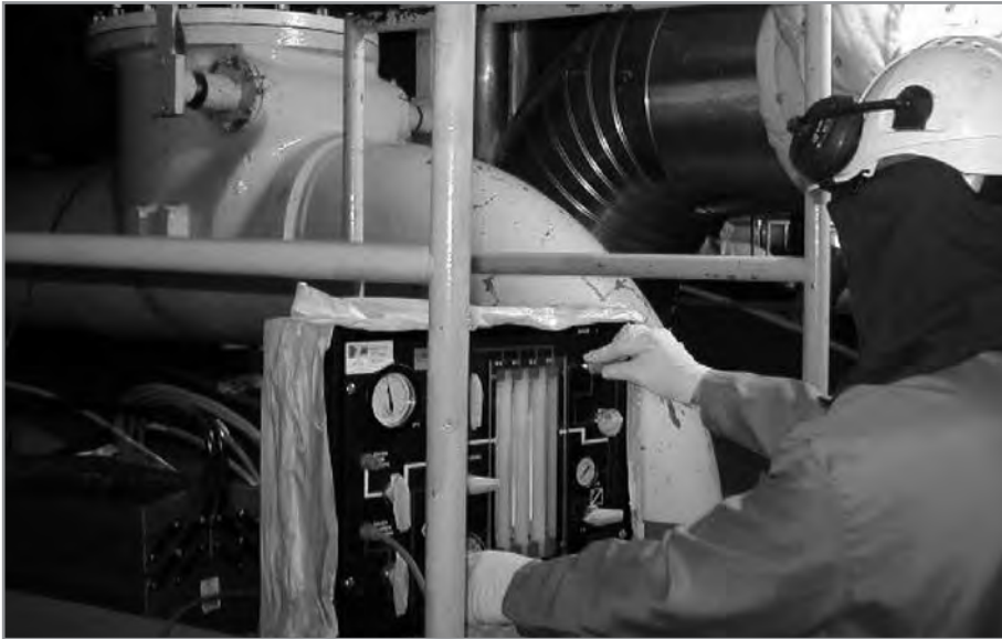
Figura 1. Equipo de medida de fugas neumático para pruebas de válvulas y penetraciones de Contención..
