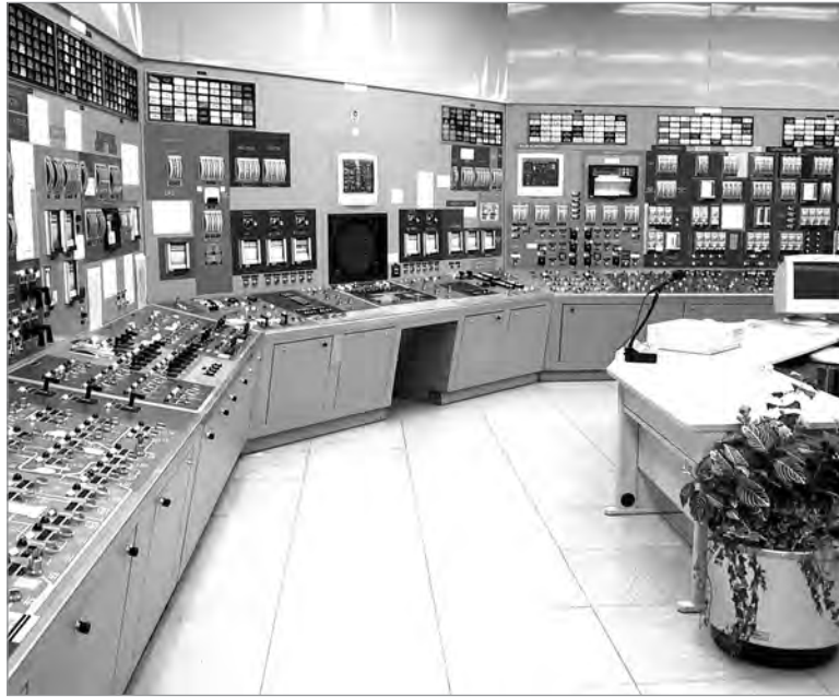
Figura 1. Sala de Control de una central nuclear. Simulador alcance total de Tecnomat
