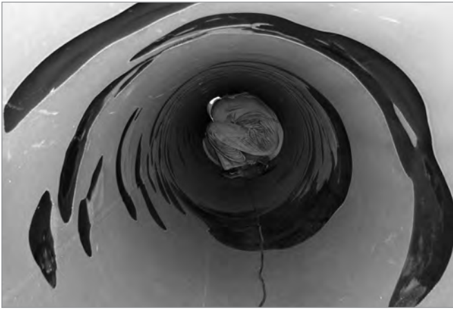
Figura 2. Degradación de la superficie interior de una tubería remediada mediante metalización.
