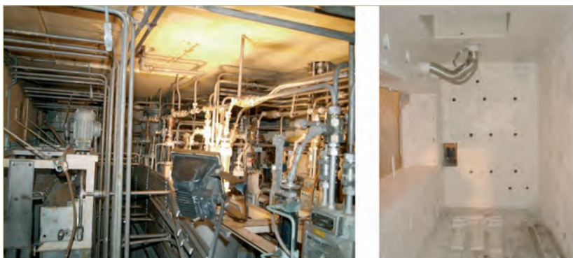
Figura 7. Estado de la celda M1 tras la extracción de los componentes interiores.
