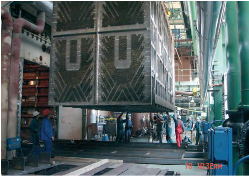
Condensador de la central nuclear de Bohunice.
