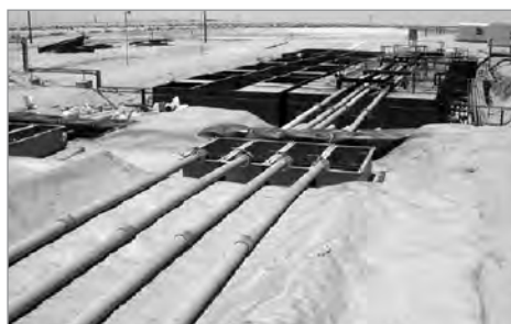
Trekkopje : Depósitos de lixiviación para minería.
