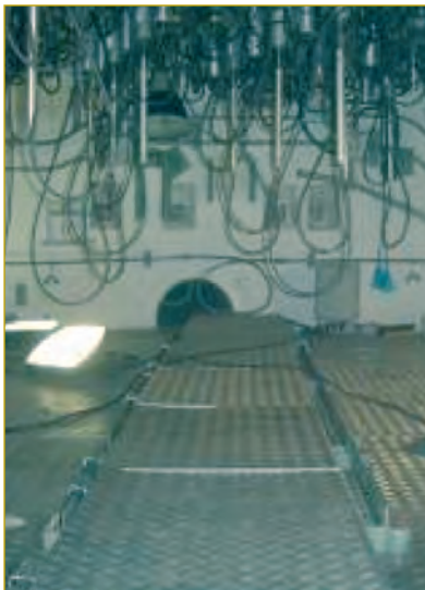
Pedestal de la vasija del reactor.
