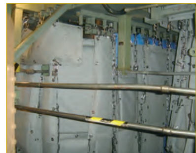
Blindajes permanentes instalados en el Pozo Seco en la Rec. 16.
