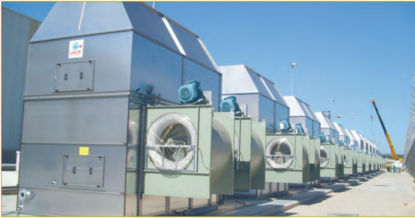
Figura 5: Nuevas Torres de Refrigeración de Tiro Forzado.
