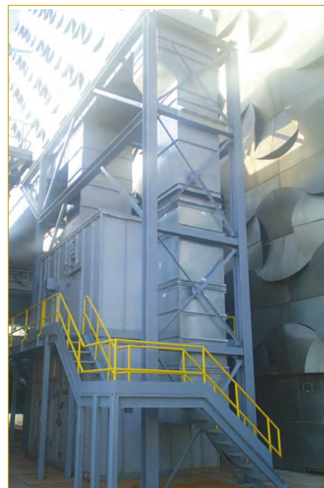
Figura 3: Unidad de Ventilación Forzada de las Barras de Fase Aislada
