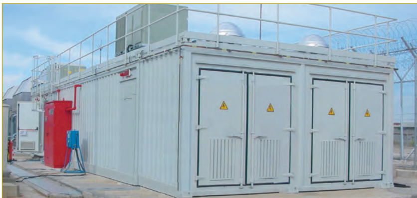
Figura 6: Nuevo Contenedor Eléctrico del TC (C.E.T.C.)
