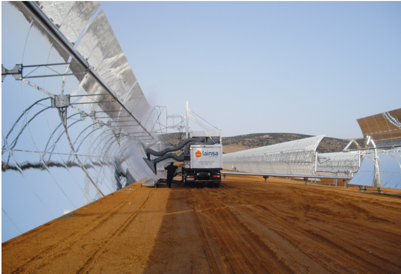
Figura 3: Imagen del sistema de limpieza de colectores cilindro-parabólicos en funcionamiento.
