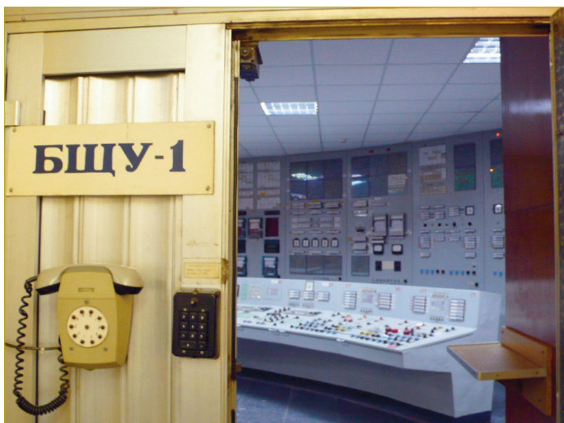
Sala de control de un reactor RBMK.
