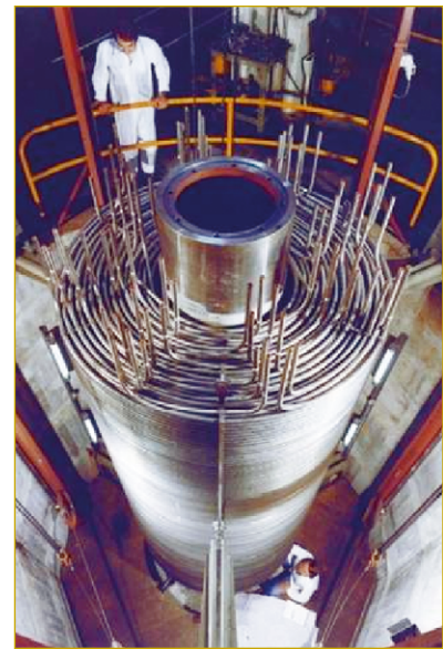
Figura 7. Vista de un tubo helicoidal del generador de vapor de helio del THTR.
