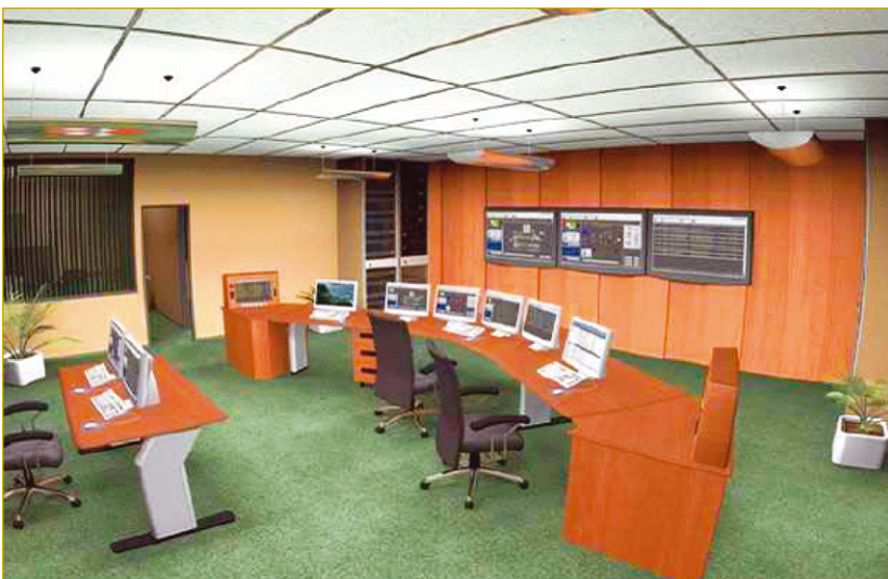
Figure 3. Sala de control prototipo de una central PBMR. (Imagen por cortesía de PBMR Ltd).
