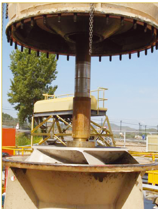
Figura 3: Desmontaje de la bomba de circulación durante la recarga de la central de Cofrentes.
