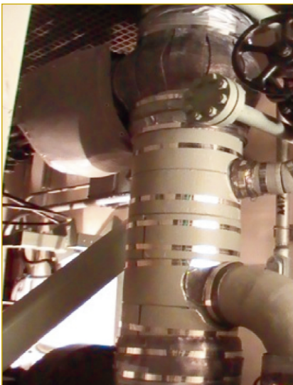
Blindajes de coquillas de 12 mm en línea de 12" del Sistema G41.
