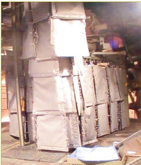
Blindajes permanentes en línea del Sistema G33 y E12.
