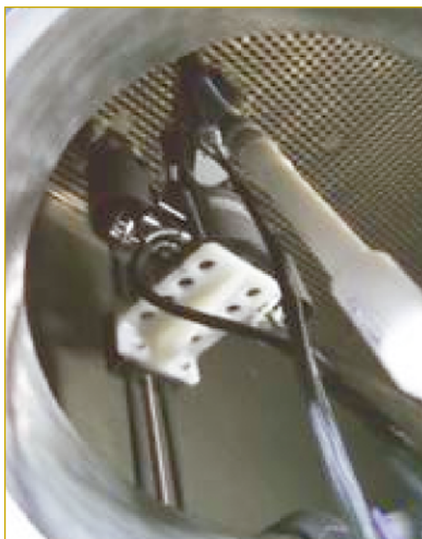
Equipo de inspección por CC.II. de tubos de Generadores de Vapor.
