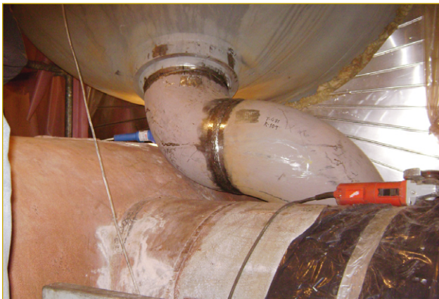
Figura 10. Detalle tubería soldada.
