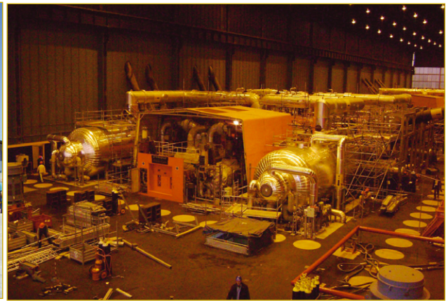
Figura 4. Vista aérea de planta de Turbina en el cambio de los MSR.
