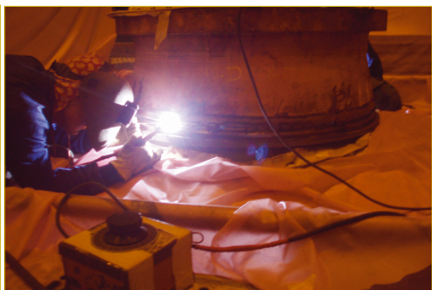
Figura 9. Detalle de soldadura del Cross Over.
