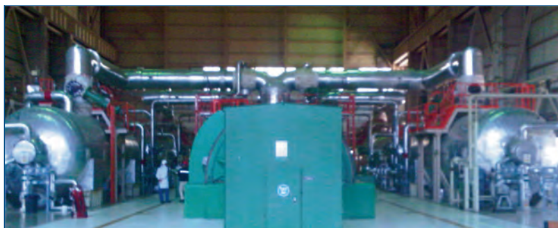
Equipos actualmente en servicio. / Equipment currently in service.
