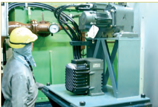
Figura 7: Posicionador de control de velocidad.
