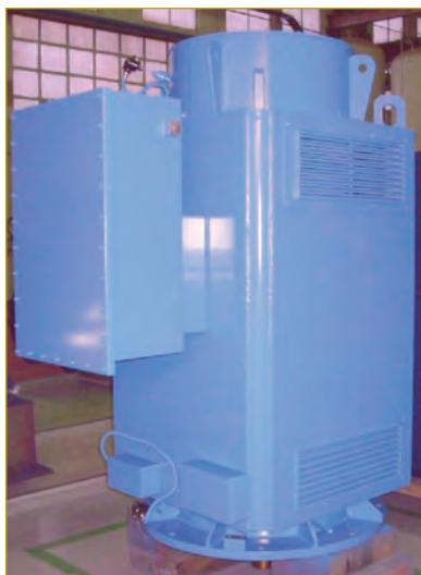
Figura 5: Motor de bomba del PCI.
