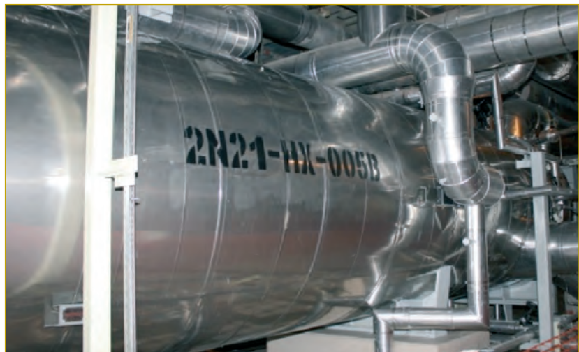
Figura 7: Nuevo calentador de agua de alimentación (5B).
