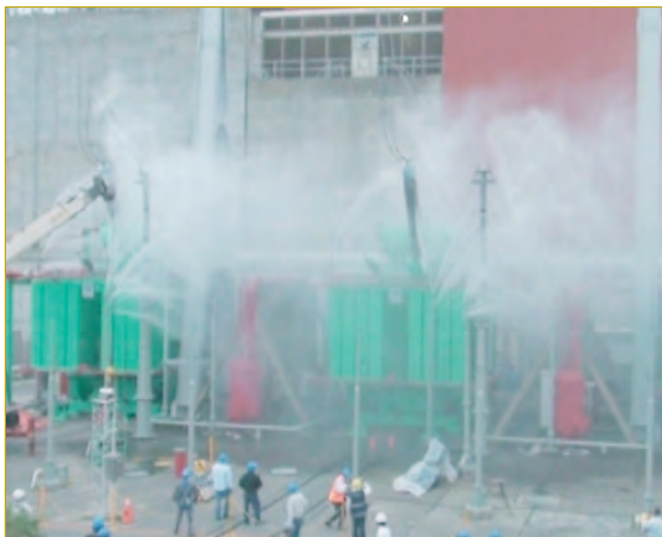
Figura 9: Prueba contra incendio de los nuevos transformadores principales.
