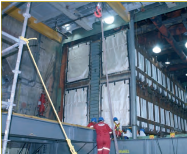
Figura 5. Cierre del condensador tras el retrofit.
