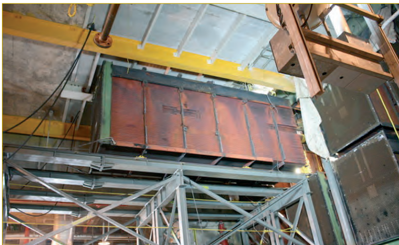
Figura 4. Extracción de módulo de haces tubulares del condensador.
