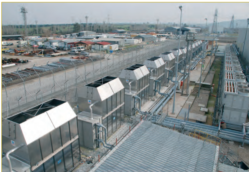
Vista panorámica de las torres de refrigeración de la turbina.
