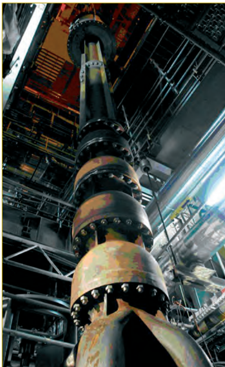
Nuevas bombas de condensado y drenaje de condensadores.
