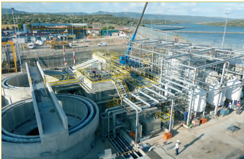
Nueva planta de pretratamiento de agua.
