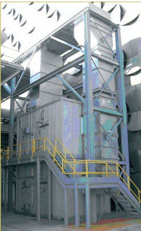
Nuevo sistema de refrigeración de las barras de fase aislada.
