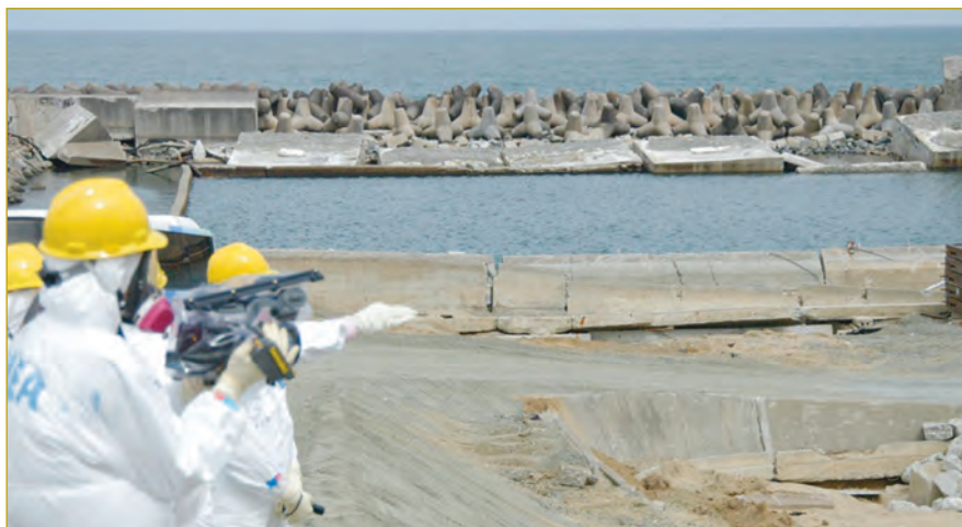
Foto 1. Equipo OIEA verificando daños en escollera de protección frente a tsunamis
