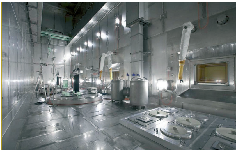
Celda de descarga para la manipulación de combustible irradiado (ZWILAG – Suiza).
