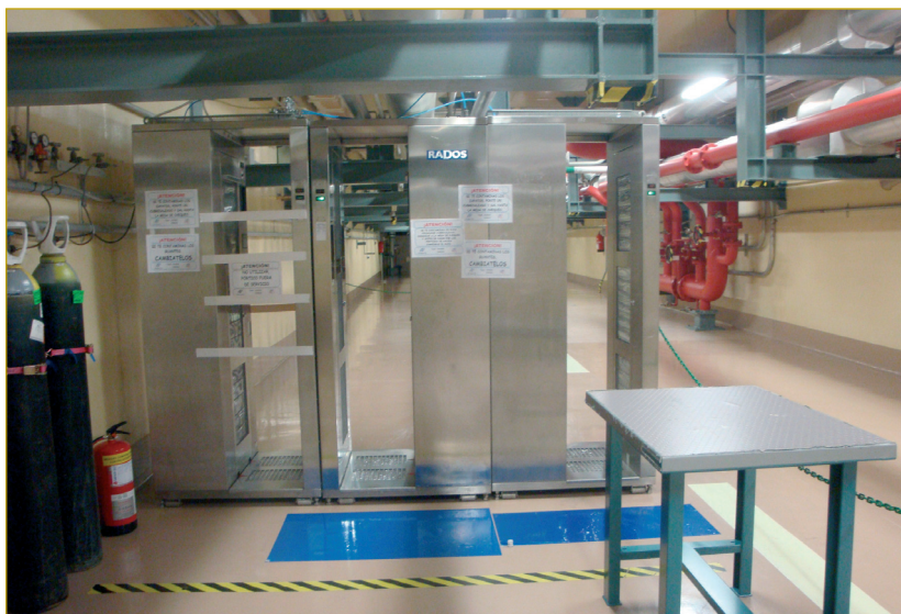
Figura 1: pórticos instalados a la salida del edificio auxiliar.
