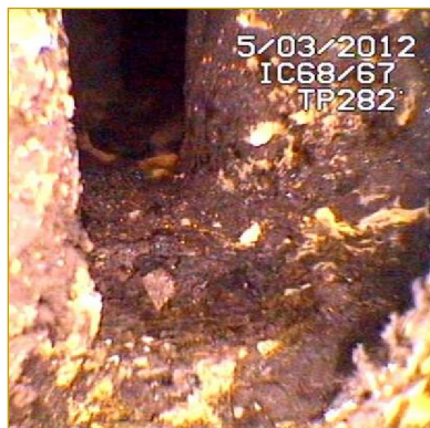
Figura 2. Lodo adherido a la placa de distribución y a los tubos del GV.
