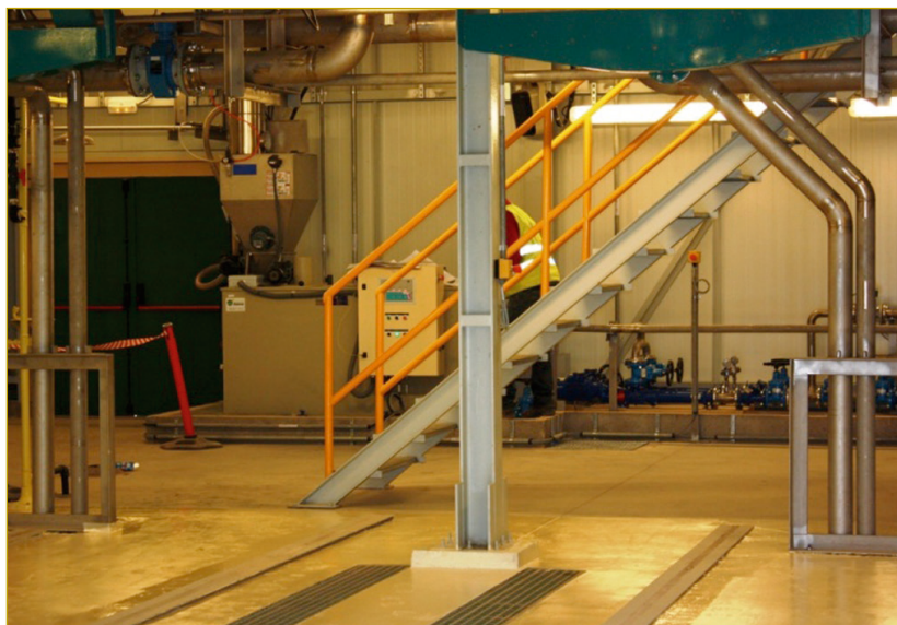
Tratamiento de fangos de la clarificadora. Sala de filtros prensa.
