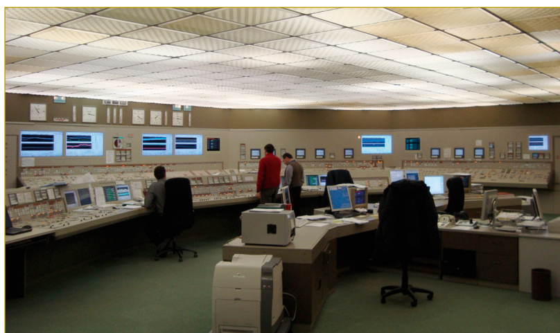
Sala de Control de CN Trillo.
