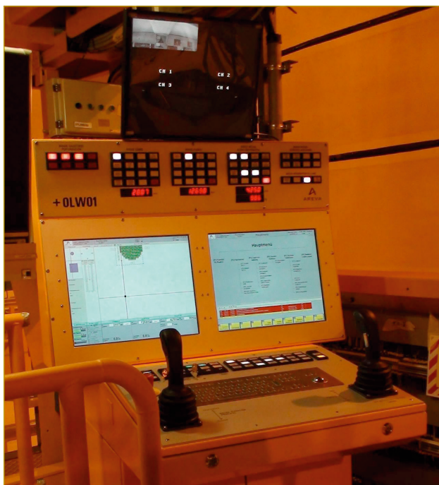
Figura 4: Sistema de Operación de la nueva máquina de recarga de CN Trillo.
