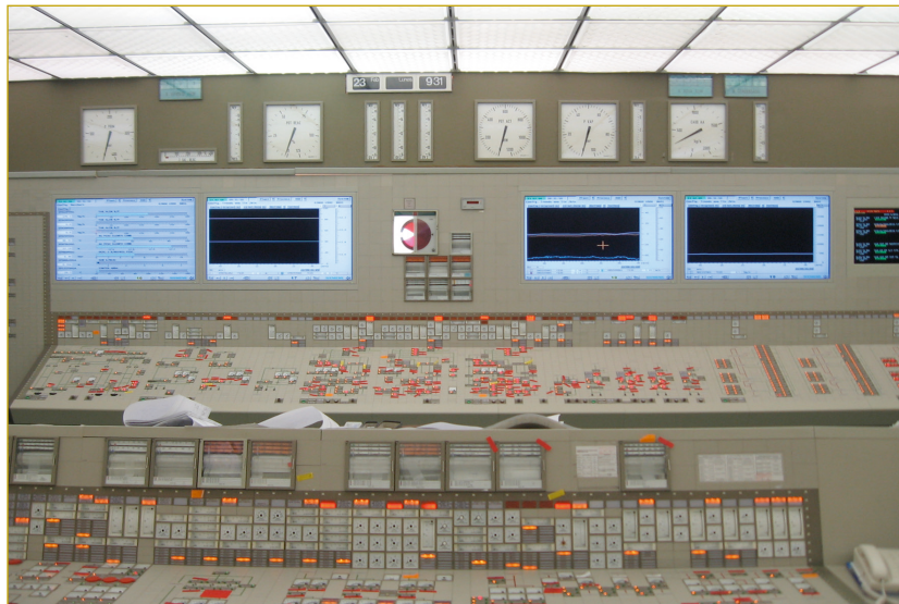
Figura 3: Aspecto de la IHM de la sala de control de CN Trillo tras el cambio del ordenador.
