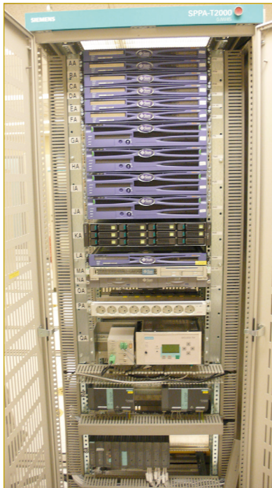
Figura 1: Cabinas del sistema modernizado.
