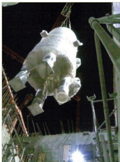
Figura 4. Introducción de los desmineralizadores APG en el edificio de auxiliares nucleares BAN.
