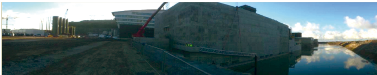
Figura 1. Vista general de la Casa de Bombas de Flamanville 3.
