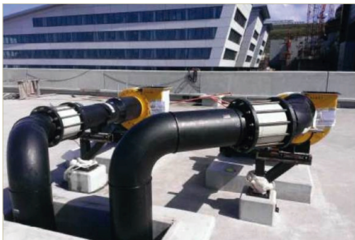
Figura 8. Extractores de hidrógeno de la planta de electrocloración sistema CTE.
