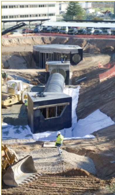
Figura 1: Aumento capacidad barranco La Vaguada C.N. Asco.
