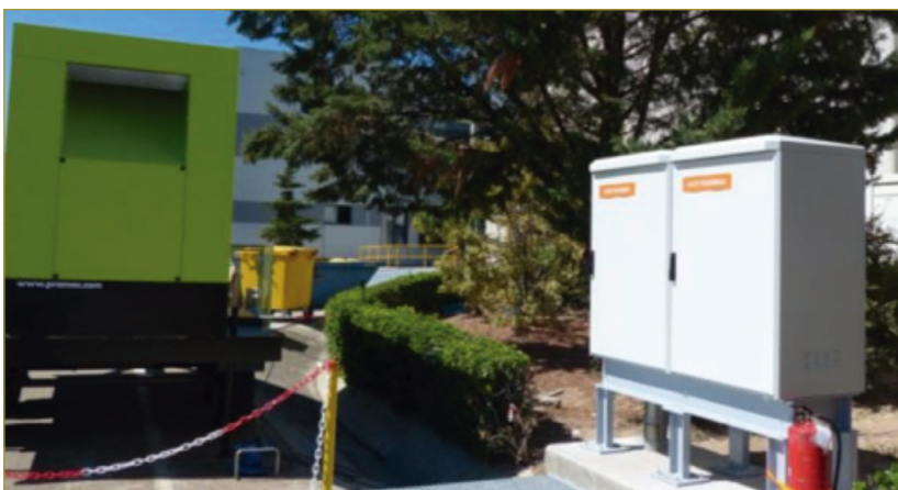
Figura 4: Grupo electrógeno y cuadros de conexión.
