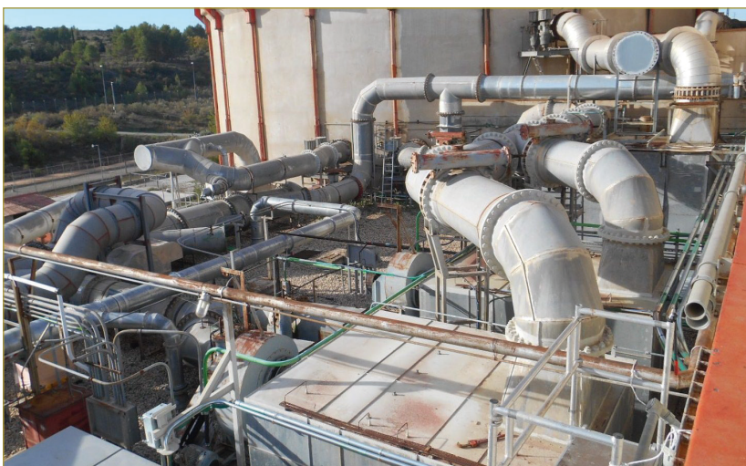
Eliminación parcial de elementos de ventilación.
