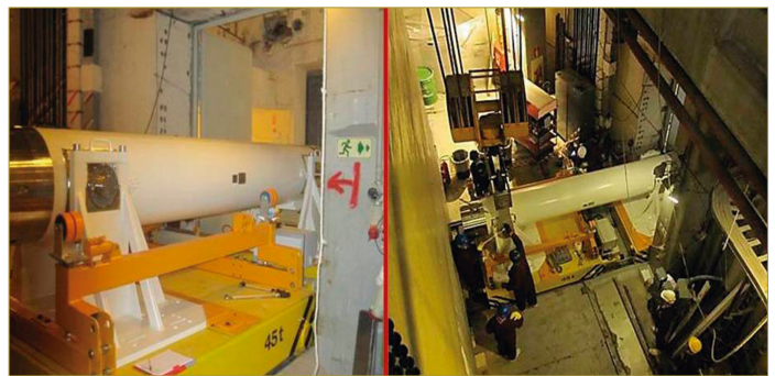
Figura 10. Contenedor en el túnel de transferencia entre el Edificio Auxiliar del Desmantelamiento y el Edificio de Contención.
