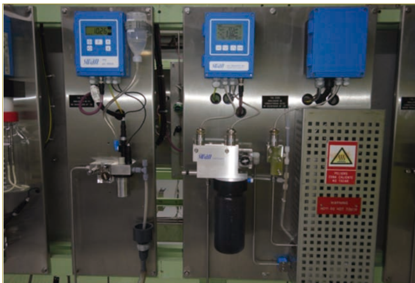
Figura 1. Analizadores en línea de conductividad y pH de agua alimentación principal (MFW).
