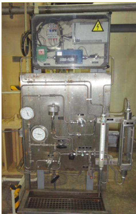
Figura 2. Panel de toma de muestra de productos de corrosión del agua de alimentación principal (MFW).
