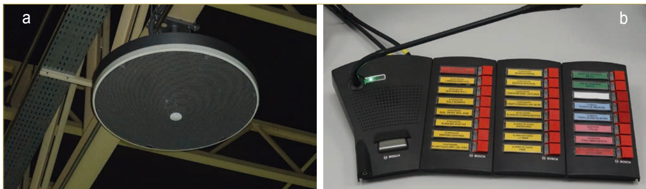
Figura 2. Sistema de megafonía del SPCL: (a) ejemplo de altavoz instalado en la nave y (b) foto de la centralita para la gestión de los mensajes y evacuaciones.
