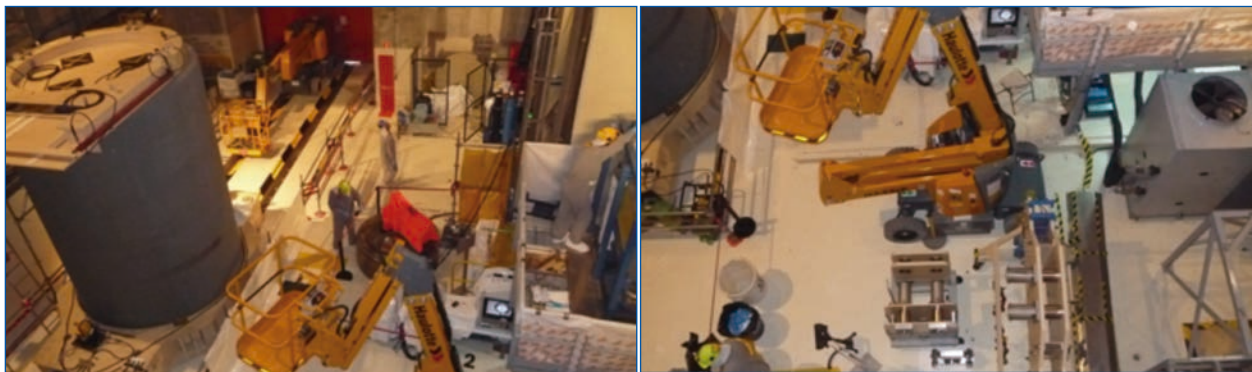
Foto 5. Disposición de equipos y componentes en el interior del edificio de Combustible. Un HI-STORM vacío y con el cortapuros colocado espera su MPC que está en fase de sellado. A la derecha asoma el DCFH más a su derecha queda la piscina. Realmente no queda demasiado espacio por donde moverse...
