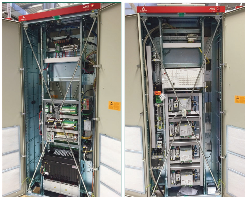
Figuras 6 y 7. Nuevas cabinas de I&C del sistema de Neumobolas para C.N. Trillo.
