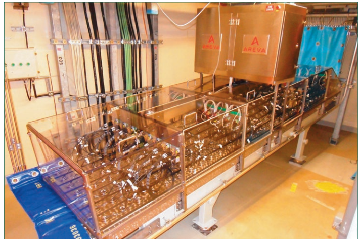
Figura 4. Ejemplo real de una mesa de medidas similar a la que se instalará en C.N. Trillo.
