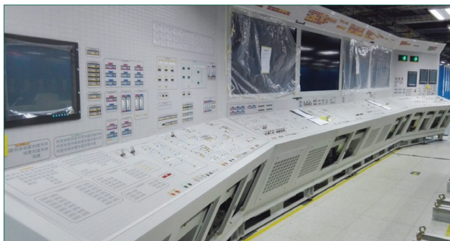
Figura 9. BUP de Yangjiang 5 en fábrica antes de empezar las pruebas FAT.
