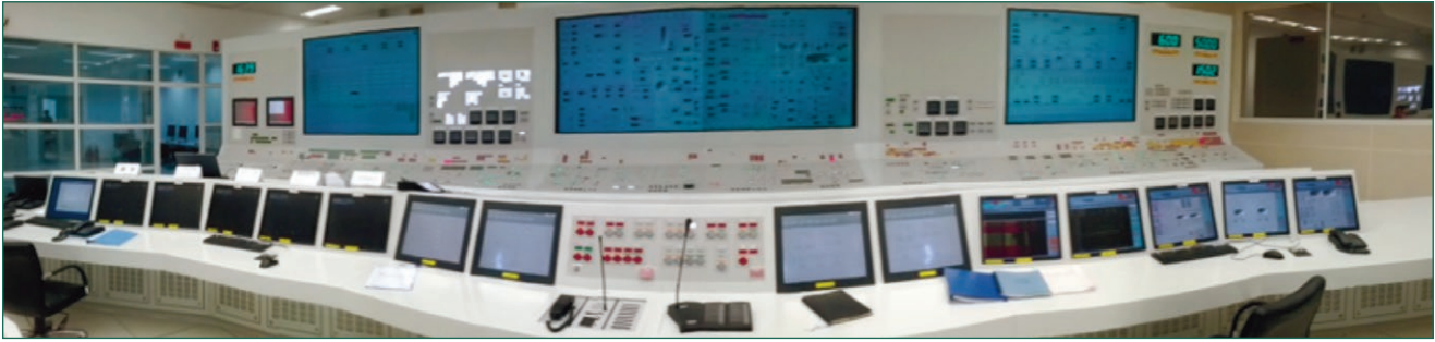
Figura 1. Foto de la sala de control de Fangjiashan 1.
