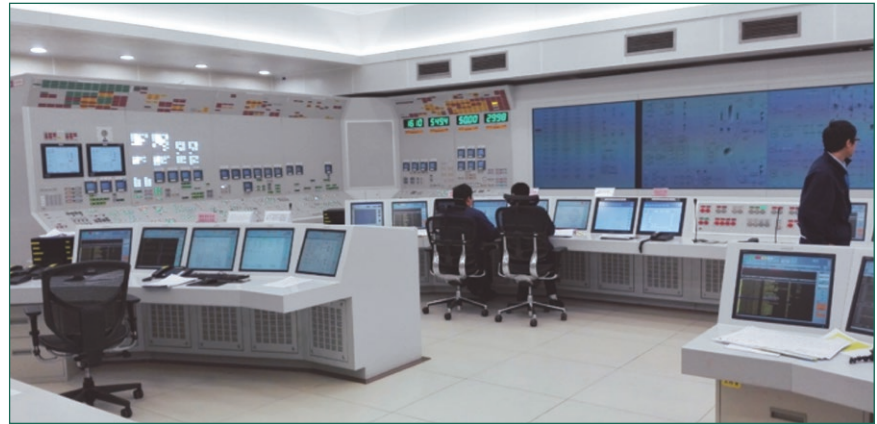
Figura 10. Fotos de la sala de control de Hainan 1.
