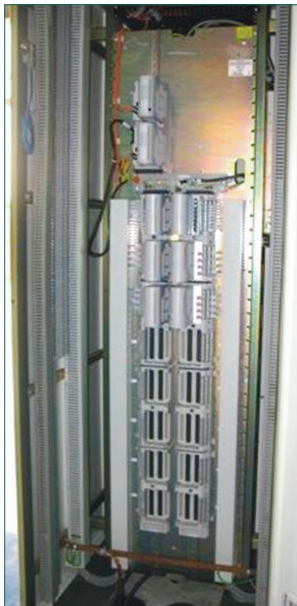
Figura 11. Cabina remota del control de nivel de calentadores y tanques de drenaje de MSR de Almaraz.
