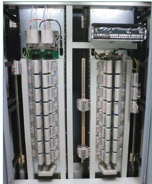
Figura 4. Cabina del SAMO de Ascó.
