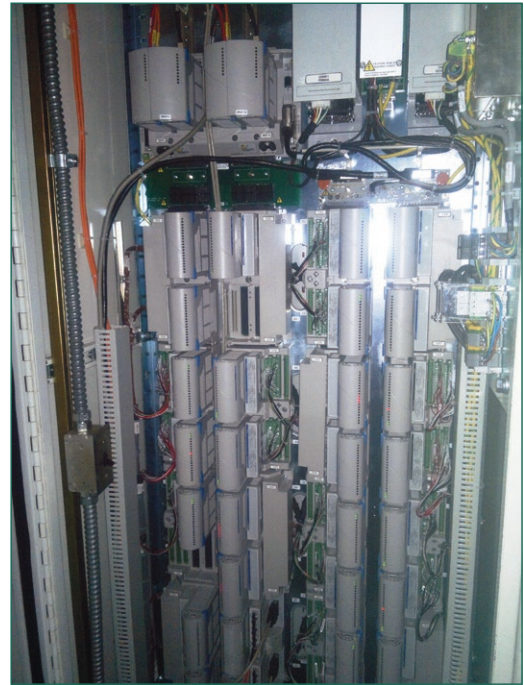
Figura 3. Detalle de montaje de una cabina del SAMO de Almaraz.
