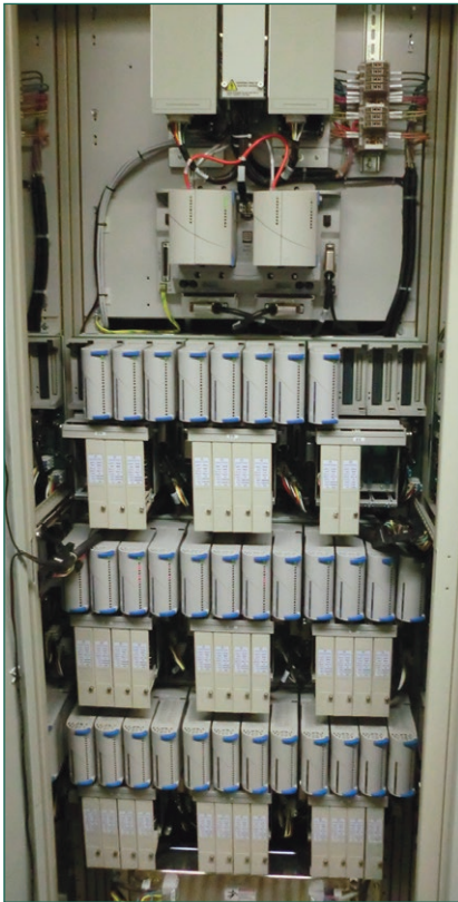
Figura 5. Cabina del ordenador de planta de Vandellós II.
