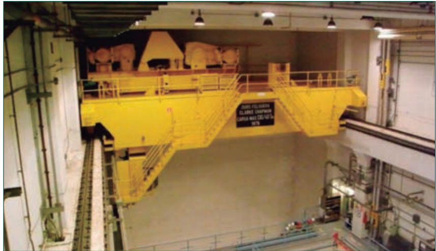
Figura 1. Puente Grúa. Edificio Combustible.
