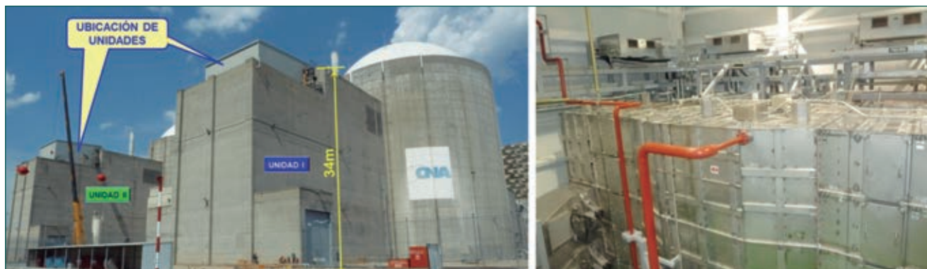
Imagen 6. Unidades de filtración sobre Edificio de Combustible y vista interior.
