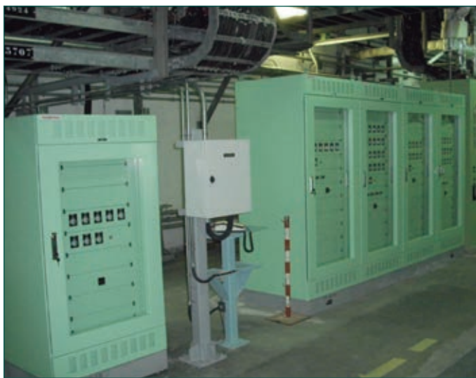
Imagen 2. Paneles de transferencia.
