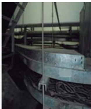
Ejemplo de cajeado metálico en bandejas eléctricas.
