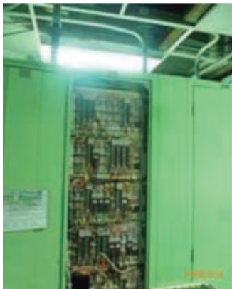
Modificaciones realizadas en cabinas Foxboro.
