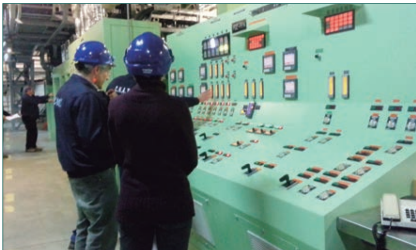
Imagen 4. Equipo de Operación realizando parada desde el PPA.
