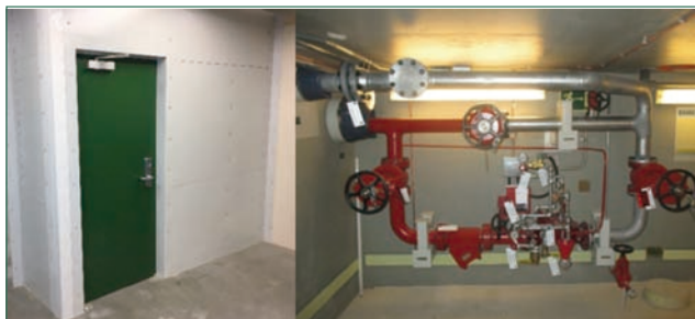
Figura 5. Compartimentación cubículo Edificio eléctrico (izquierda) y ampliación de sistemas de extinción (derecha).
