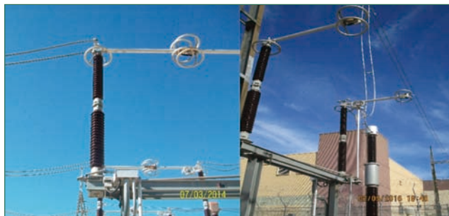
Figura 4. Seccionadores de origen (izquierda) y nuevos seccionadores (derecha).
