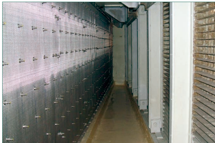
Figura 2. Cámara intermedia: filtro de finos (izquierda) y filtro de gruesos (derecha).
