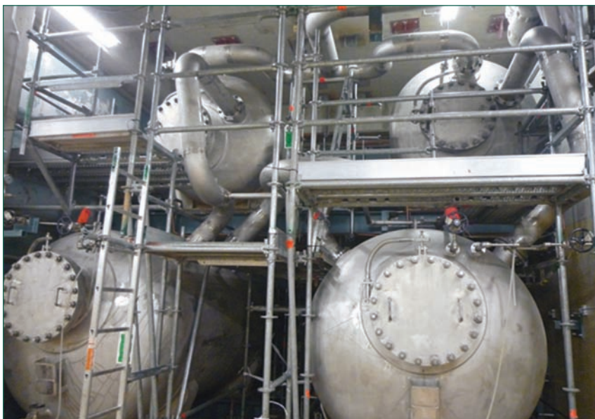
Filtros de la central nuclear Vandellós II.
