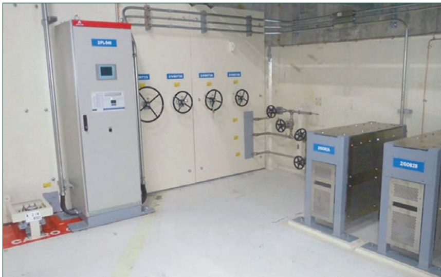
Cuarto de control.
