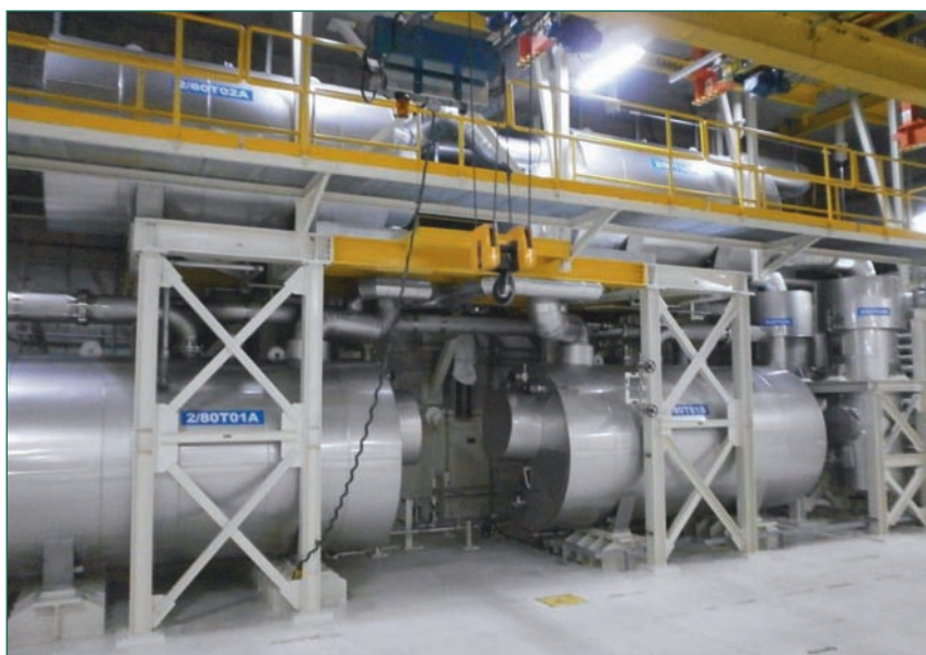
Filtros de la central nuclear Ascó.
