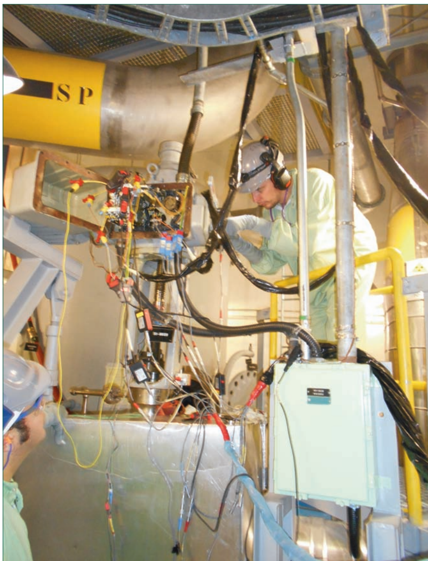
Figura 3. Instalación de sensores para diagnóstico in situ de una válvula motorizada.
