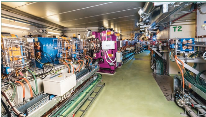
Figura 2. Vista interior del búnker de hormigón, donde se observan los dos anillos aceleradores.
