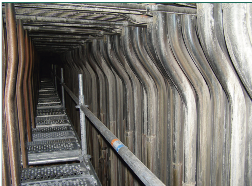
Figura 1. Intercambiadores de calor en el interior de la caldera de una central térmica.
